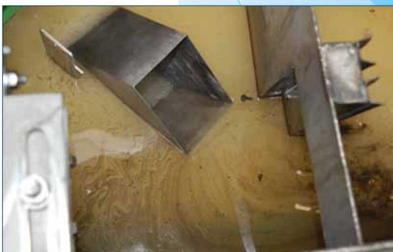
Una scrematrice Suparskim® in azione, montata nel serbatoio di depurazione del Cliente. L'olio è automaticamente e immediatamente estratto dal flusso.
